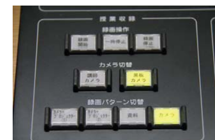
教卓に組み込まれた講義収録関連のスイッチ。収録の開始/停止、カメラ切り替え、収録パターン切り替えなどの操作を教員の手許で行える。
