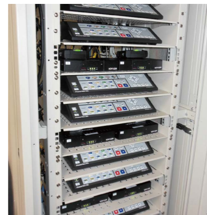
サーバルームの「Power Rec SS」
